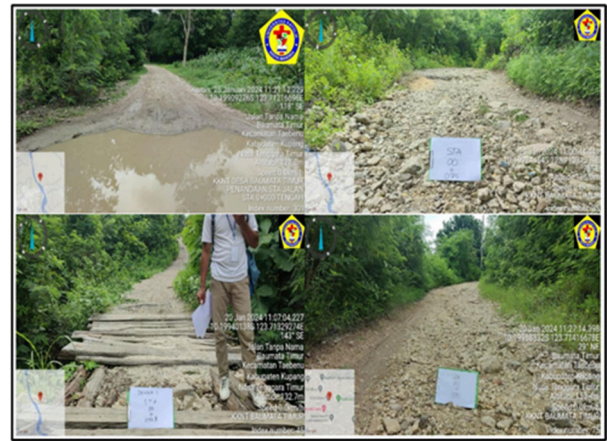
Gambar 3. Kondisi fisik jalan Dusun I
