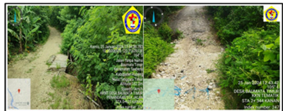
Gambar 4. Kondisi erosi dan longsor
