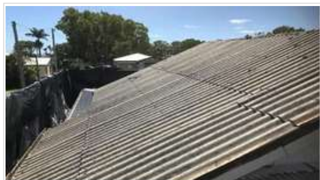
Gambar 3. Penggunaan atap asbes
